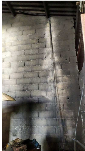
Photo 02 du 23/06/2022 : Vue des câbles pénétrants
