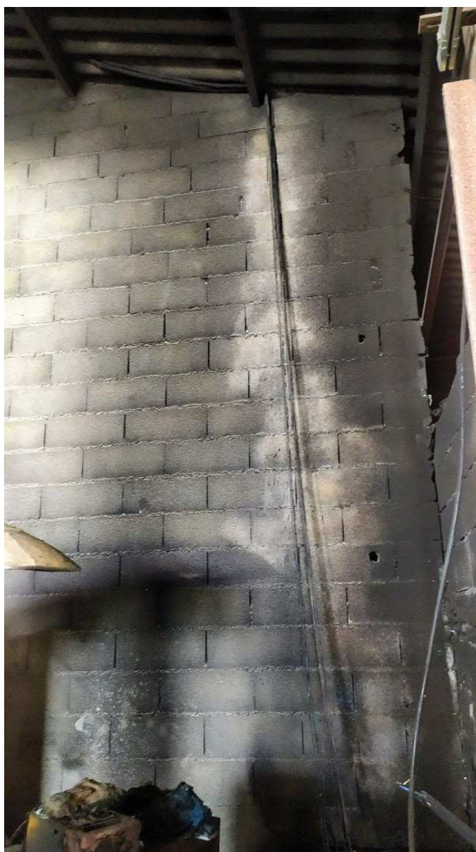
Ph 07 - Traces de recuite de suies des gaines de câbles
