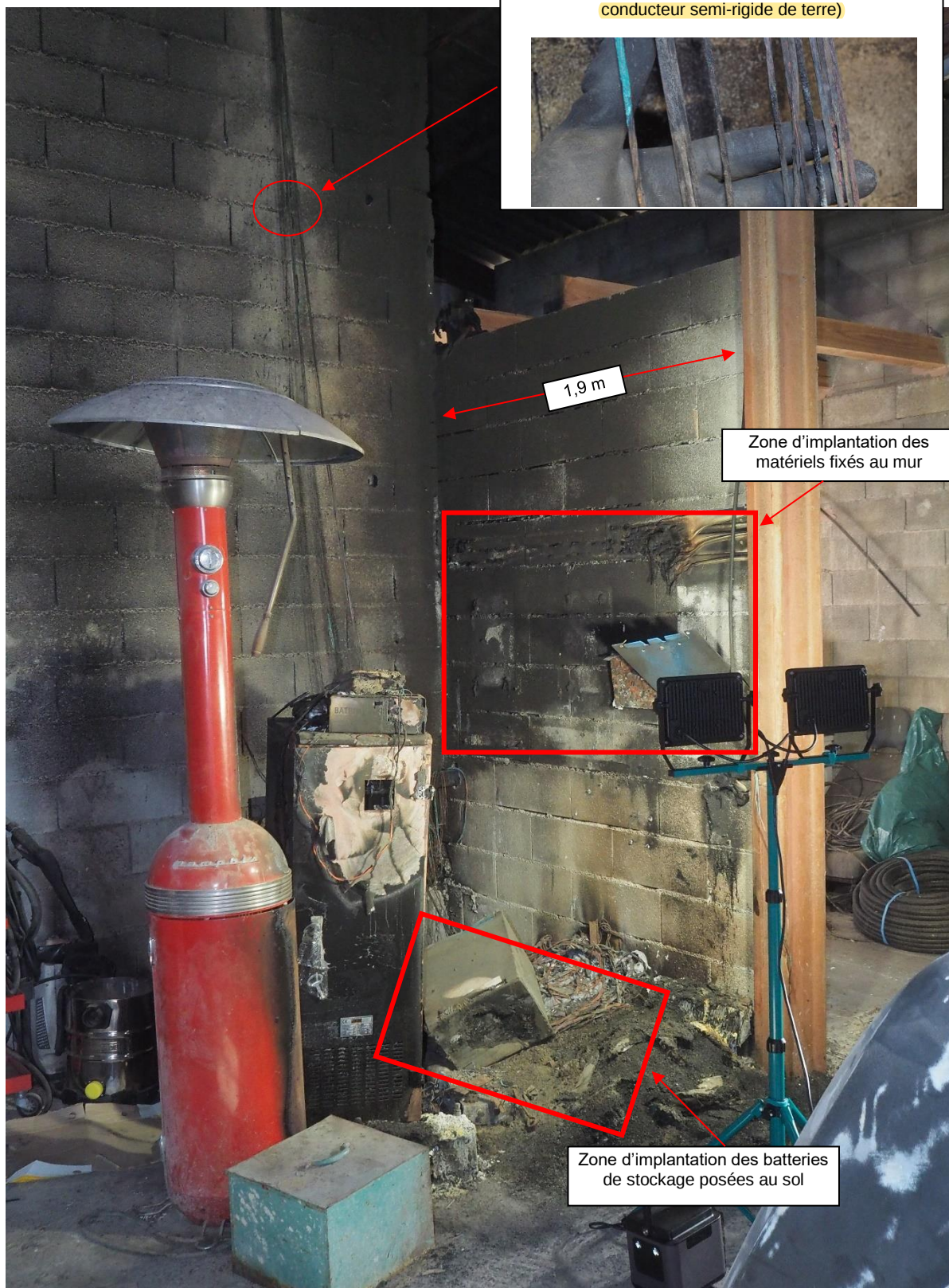
Figure 1 – Localisation de l'installation sinistrée
