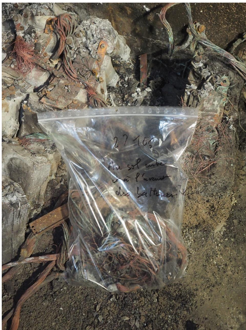
Figure 13 - Eléments prélevés au niveau des batteries de stockage et laissés sur place
