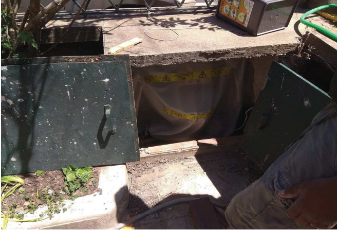
▼ 228 - Protection compteur électrique par EDF
