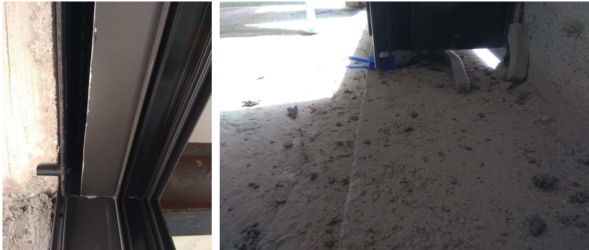
Défaut d'appui du châssis fixe (R3)- 169 ▲
