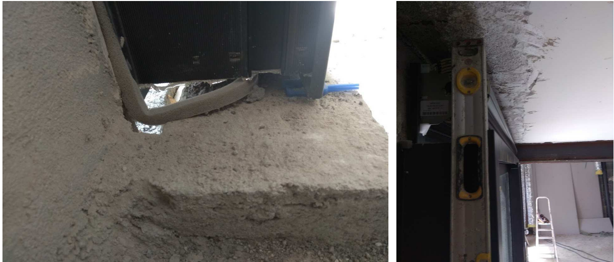
Défaut de largeur tapée (200 mm) et débord du VR - 167 ▲
