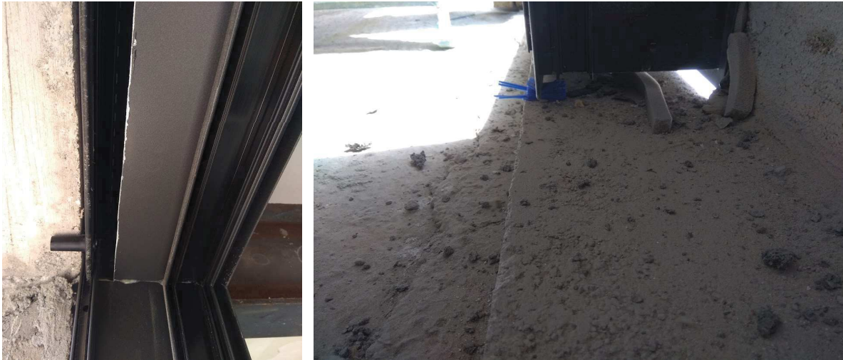
Défaut d'appui du châssis fixe (R3)- 169 ▲
