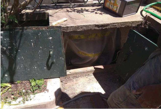
▼ 228 - Protection compteur électrique par EDF
