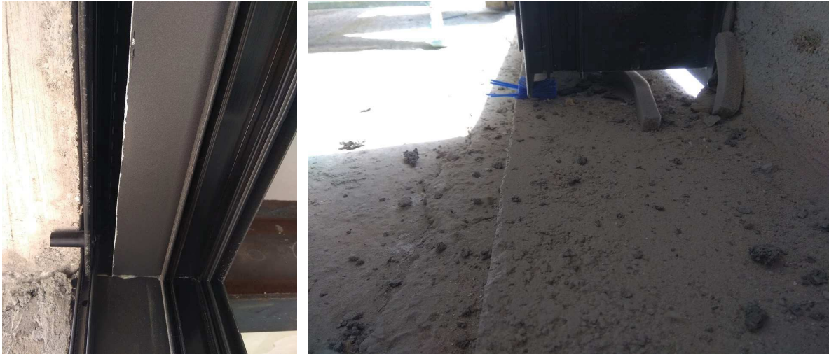
Défaut d'appui du châssis fixe (R3)- 169 ▲
