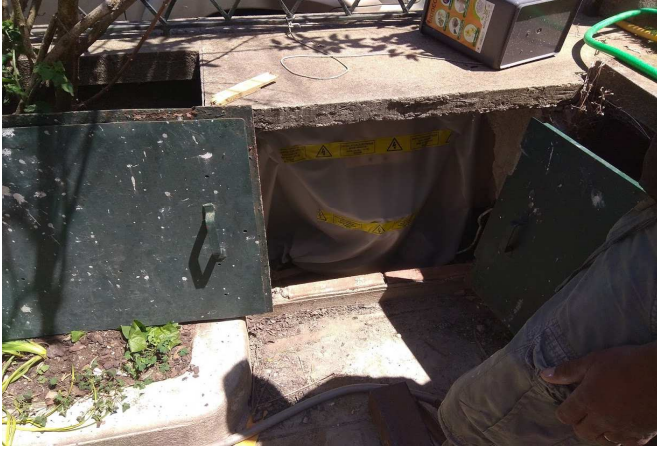
▼ 228 - Protection compteur électrique par EDF
