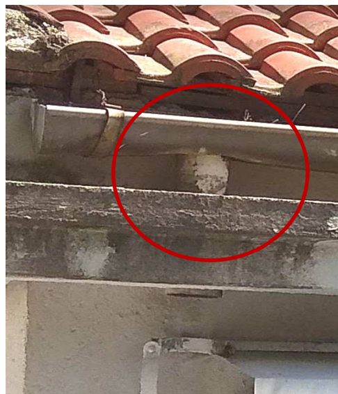
Naissance gouttière à réviser - 207 ▼
