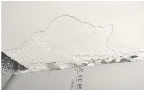
▼ 188 - Support de plâtre insuffisamment homogène pour envisager une reprise plâtre
