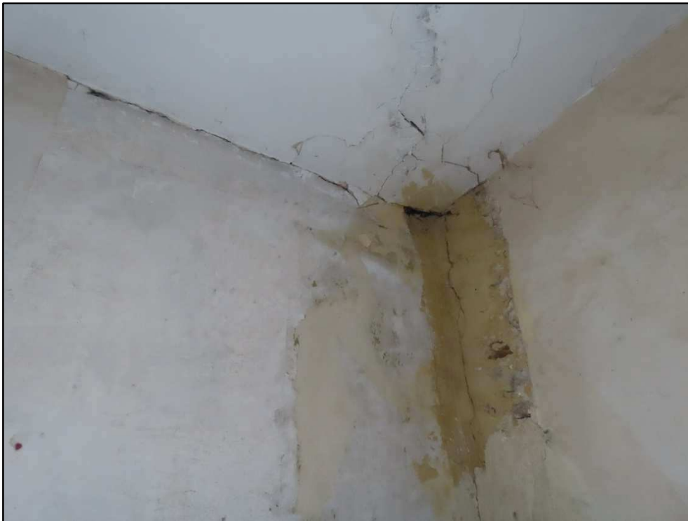
Les plafonds en plâtre ont été soulevés par l'explosion, ils n'ont plus bougé.
