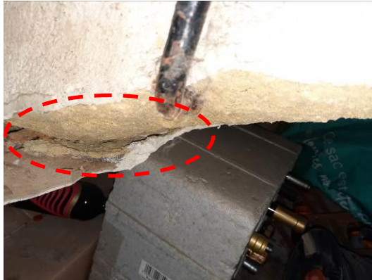
Eclat en sous face de l'escalier
