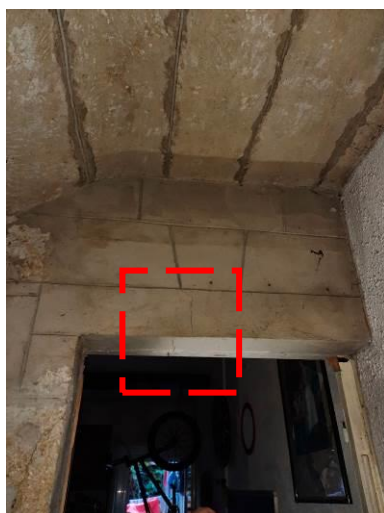
Fissure sur linteau de la porte
