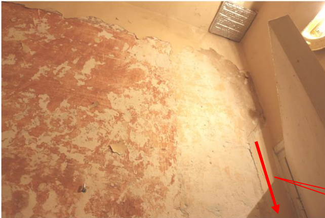
R1 paroi murale wc
