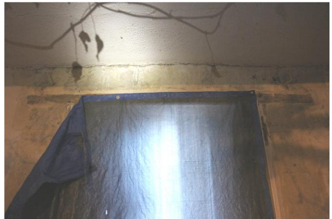
Rdc vue du séjour linteau sur fenêtre endommagée
