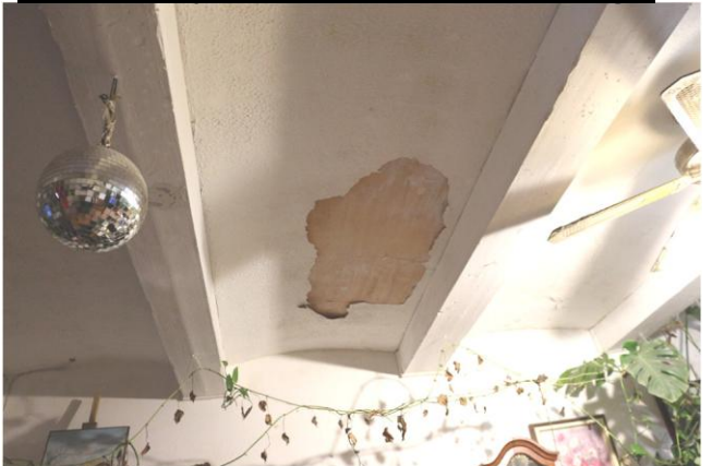
Rdc vue du séjour décollement de peinture en plafond
