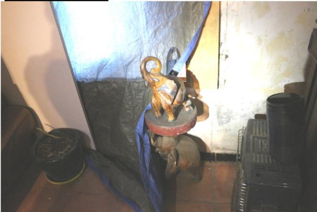
Rdc vue du séjour allège sur fenêtre endommagée
