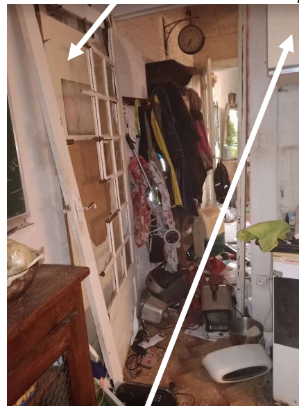
Meuble retiré après l'explosion
