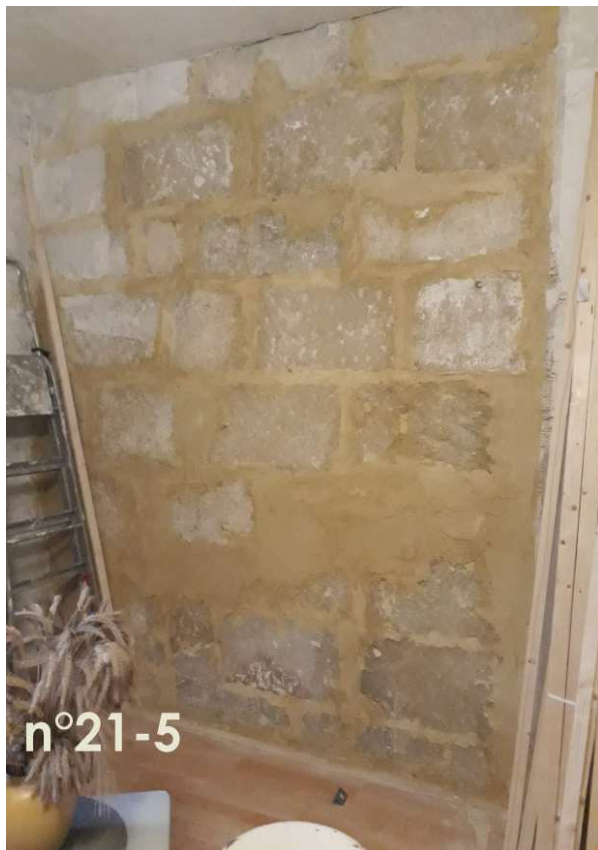
Enduit chambre nord R+2 : Non Datée
