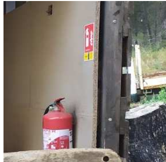
Photos 19 - Extincteur Eau 6 L / Graineterie
