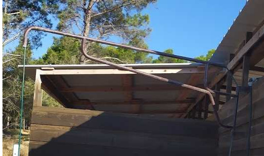
Photos 17 - Potence de douche
