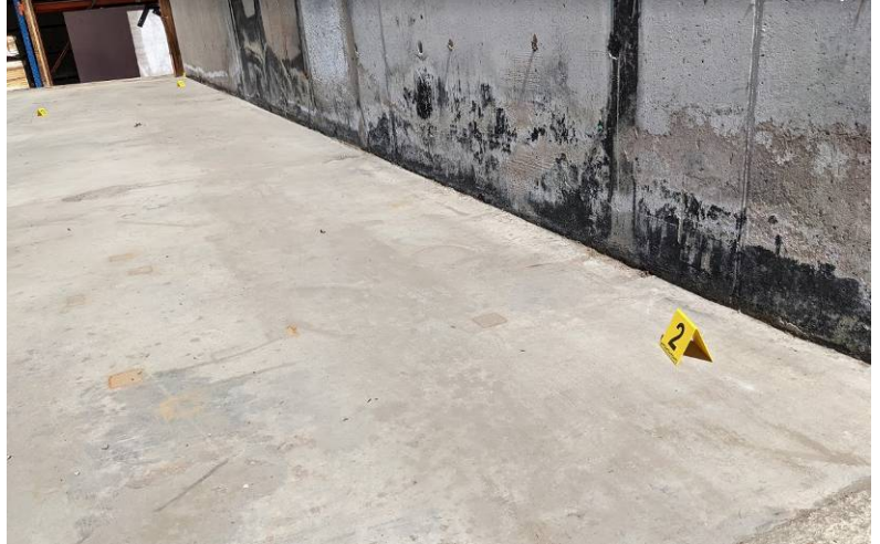
Trace de carbonisation du bureau sur mur béton
