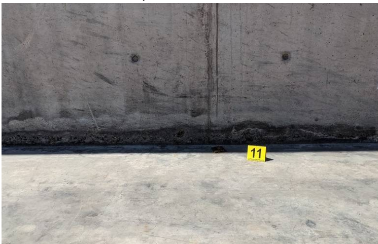
Dessiccation base du mur béton
