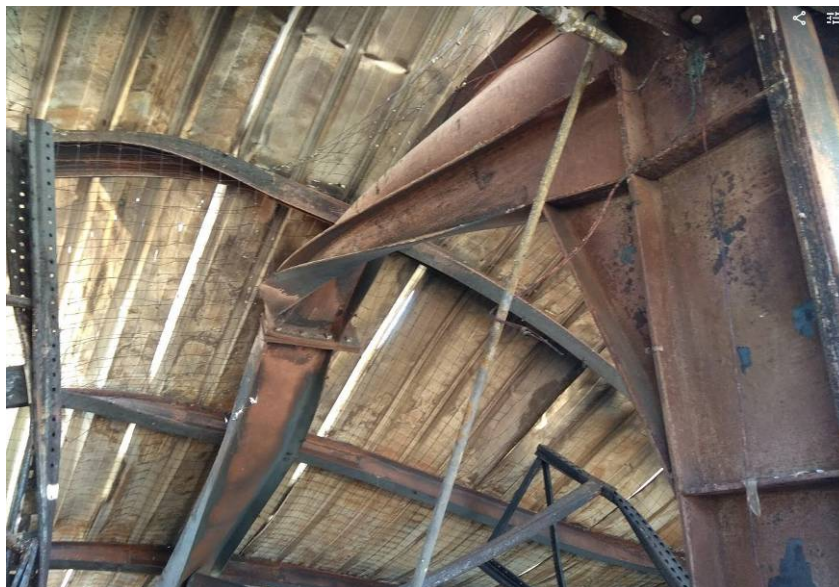
Déformation du semi-portique de charpente métallique au droit du stockage des ruches et des racks
