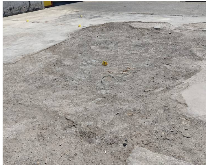
Important éclatement béton continu
