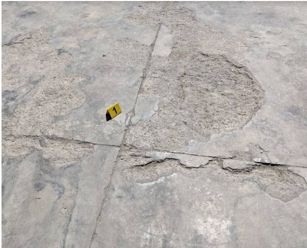
Joints de dilatations et éclatement discontinu
