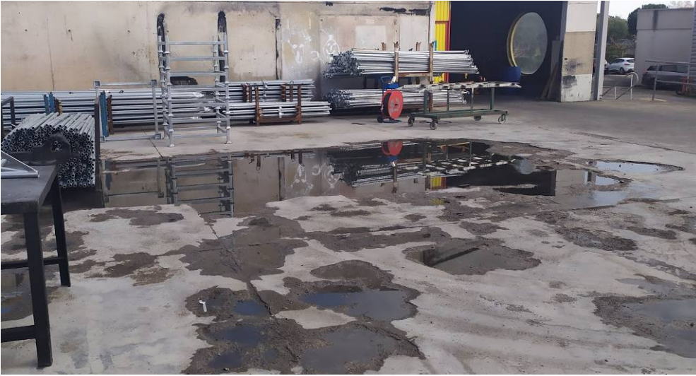
Photo n°12 - Vu de l'altération de la dalle béton après déblaiement
